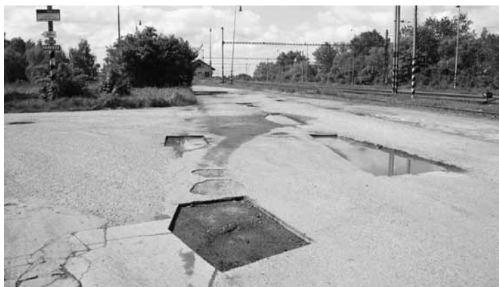
Výtlky na ulici Staničnej by mali byť v týchto dňoch už minulosťou.
